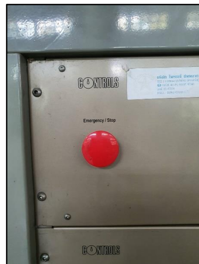
รูปที่ 2 ปุ่มหยุดการทำงานฉุกเฉิน
